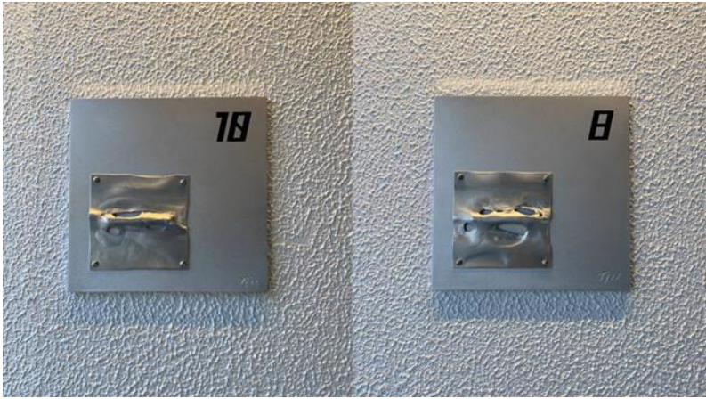
素材：アルミ 基準階EVホール
